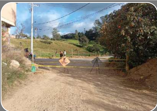
Señalización con cinta de peligro de excavaciones profundas
