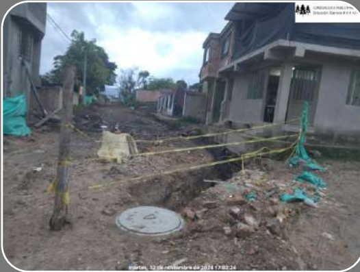
Señalización con cinta de peligro de excavaciones profundas
