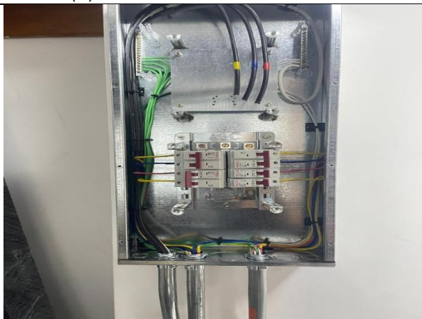
20. Instalación de tablero eléctrico en cabina (2)
