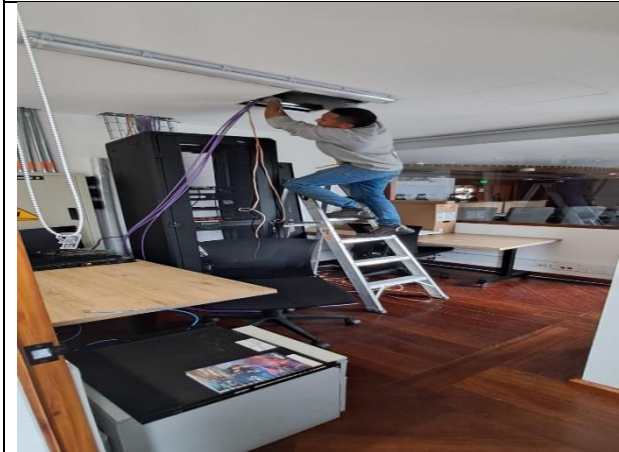
5. cableado piso 9 sala 3 micrófonos y parlantes
