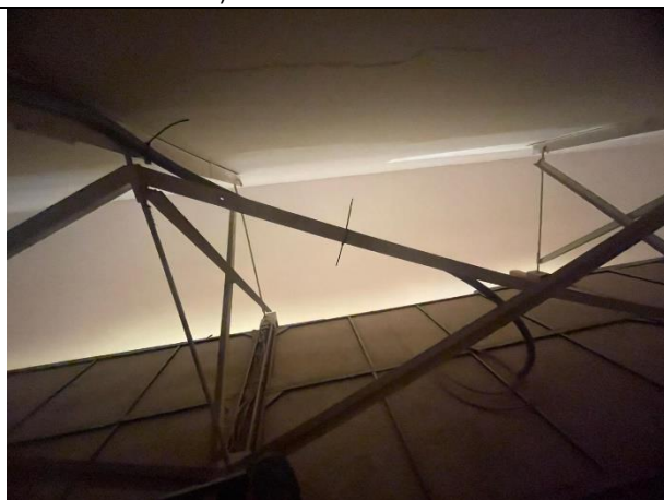
13. cableado en techo (2)
