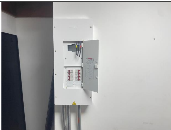
22. Instalación de tablero eléctrico en cabina (4)
