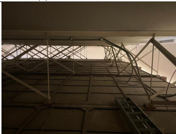
8. cableado e infraestructura para audio en techo (6)
