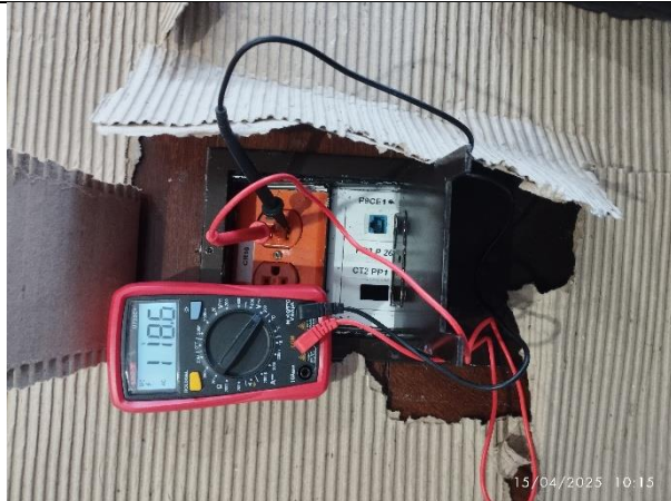
4. Validación puntos eléctricos
