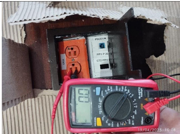
6. Validación puntos eléctricos
