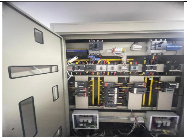
2. Conexión a tablero eléctrico 4 piso (2)
