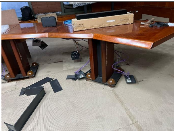
4. cableado e infraestructura (2)
