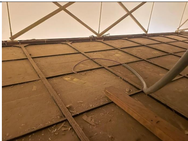
9. cableado e infraestructura para audio en techo (7)
