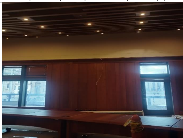
36. punto de Cámara
