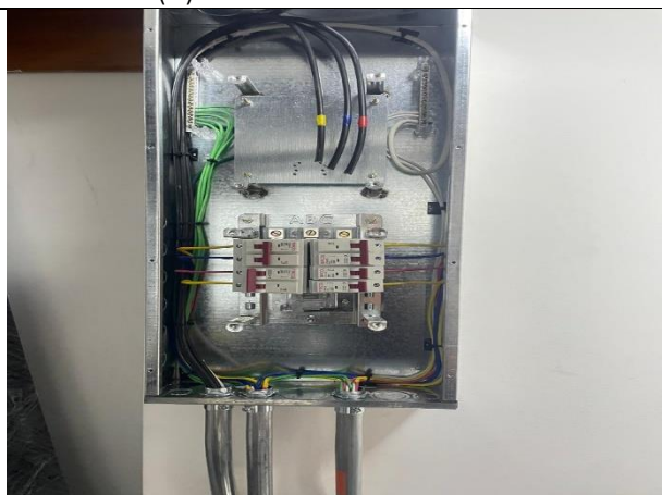
23. Instalación de tablero eléctrico en cabina
