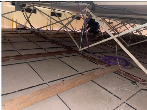
7. cableado e infraestructura para audio en techo (5)
