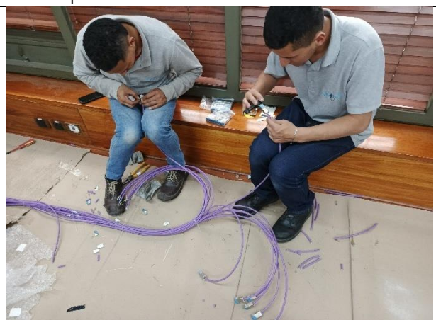
12. Ponchado de cables
