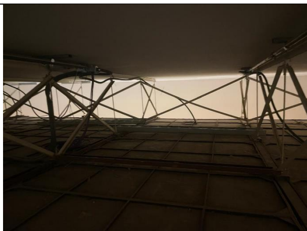
5. cableado e infraestructura para audio en techo (3)
