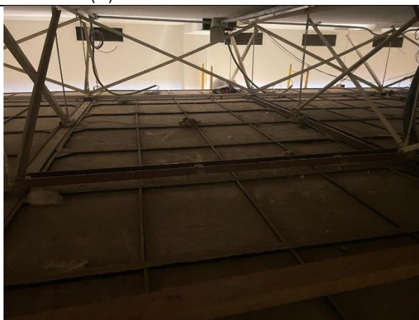
6. cableado e infraestructura para audio en techo (4)
