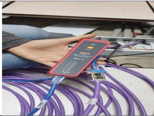
30. verificación puntos de red mesas_1
