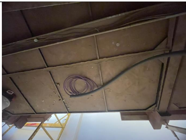
15. cableado en techo (4)
