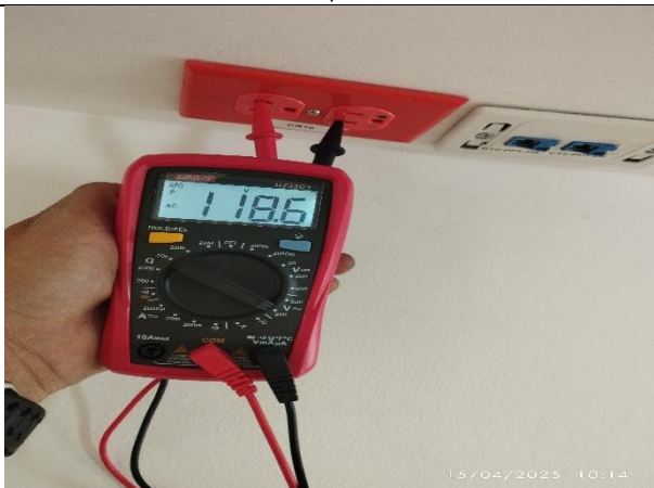
5. Validación puntos eléctricos
