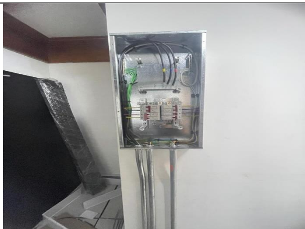
21. Instalación de tablero eléctrico en cabina (3)
