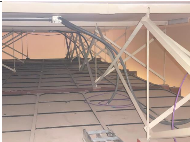
17. cableado en techo
