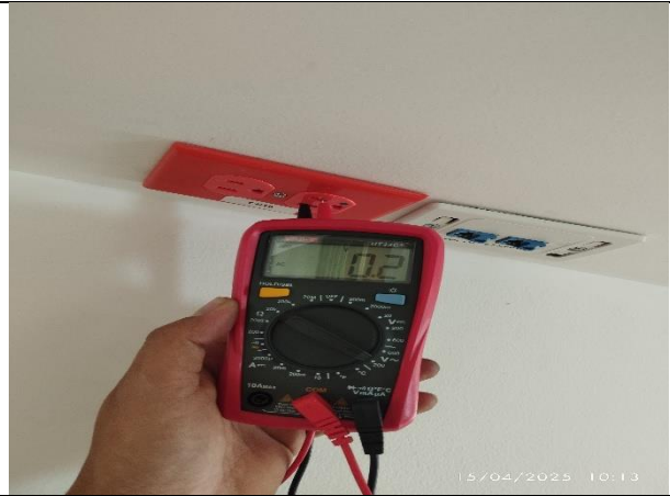
8. Validación puntos eléctricos
