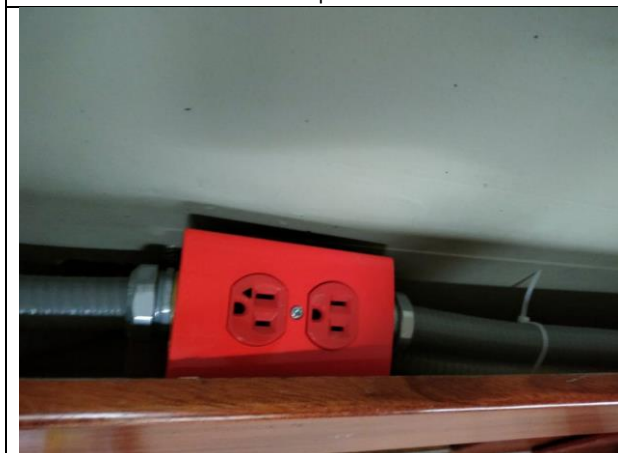
5. Identificación puntos eléctricos
