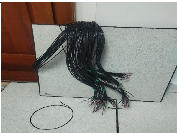
12. Cableados de iluminación
