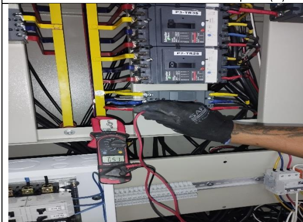
5. Conexión a tablero eléctrico 4 piso (5)
