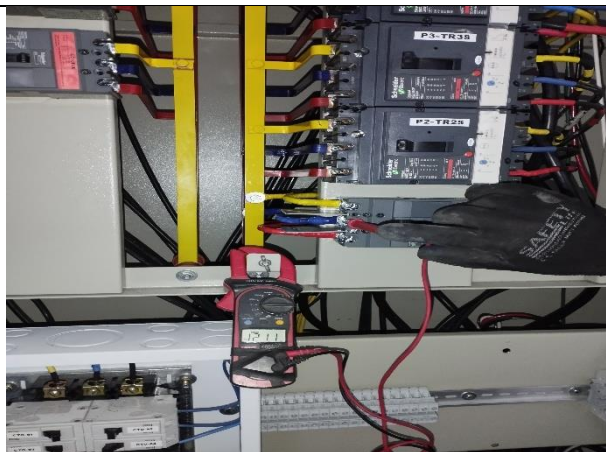
4. Conexión a tablero eléctrico 4 piso (4)
