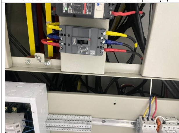
7. Conexión a tablero eléctrico 4 piso
