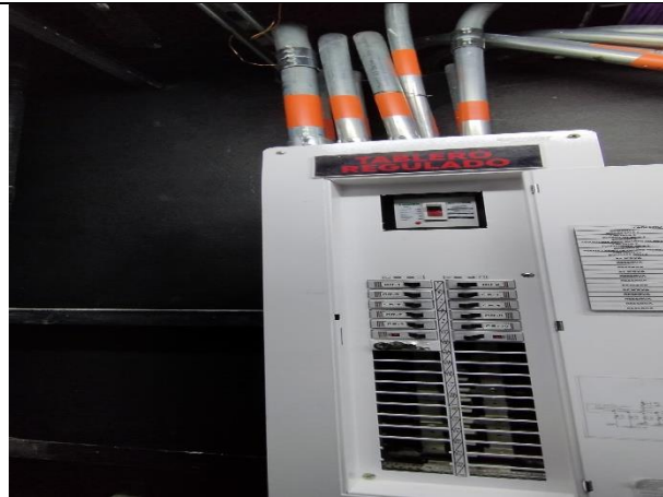
9. Validación puntos eléctricos
