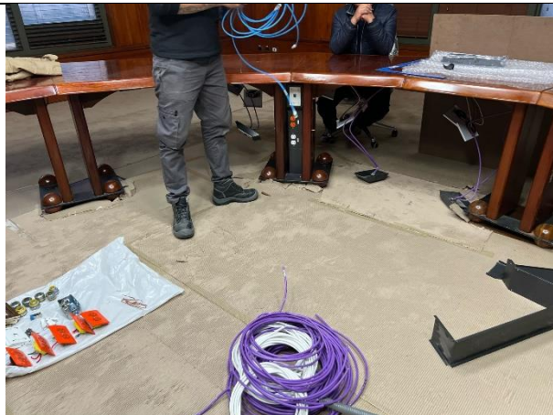
5. cableado e infraestructura
