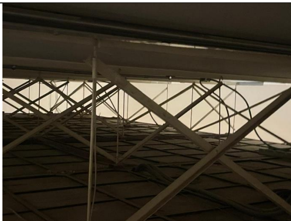
10. cableado e infraestructura para audio en techo
