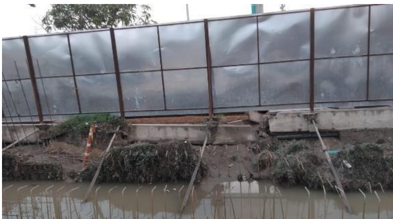
Ilustración 42. Derrumbe por inundación canal perimetral
