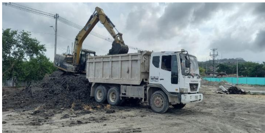
Ilustración 15. Retiro material sobrante
