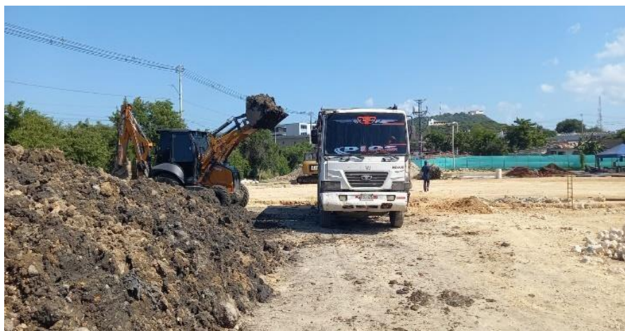
Ilustración 14. Retiro material sobrante
