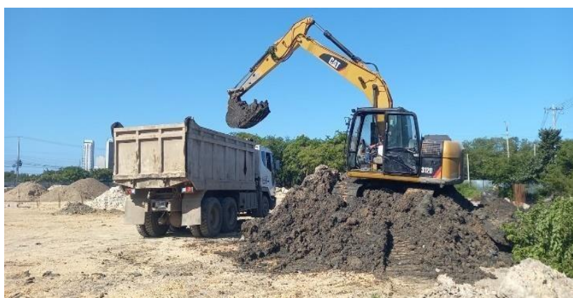
Ilustración 13. Retiro material sobrante
