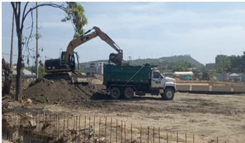
Ilustración 17. Retiro material sobrante
