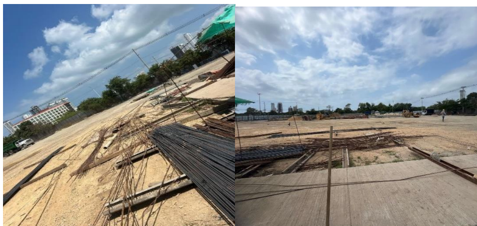
Ilustración 73. Orden y limpieza varillas de acero.
