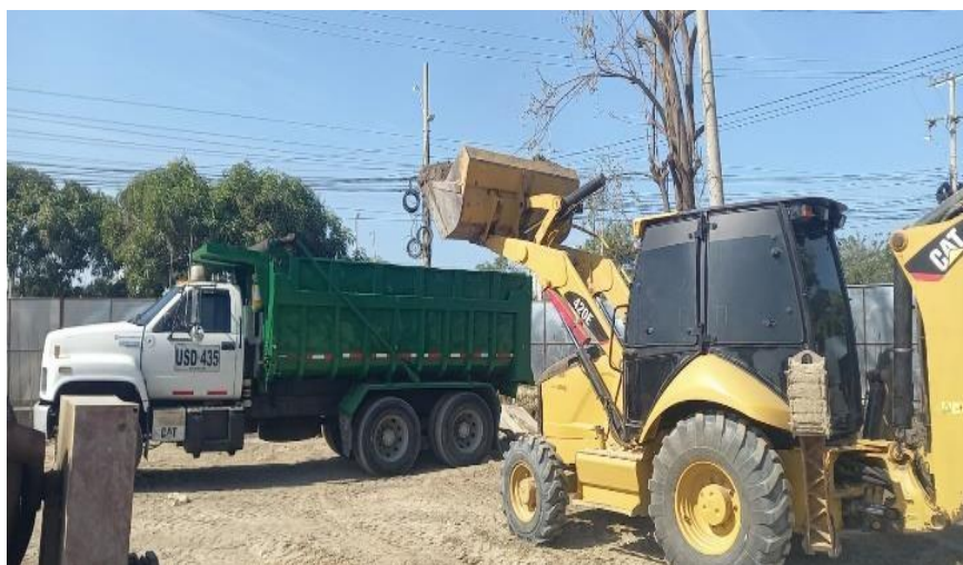
Ilustración 18. Retiro material sobrante
