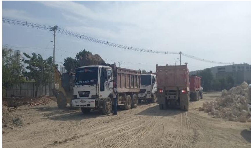
Ilustración 19. Retiro material sobrante
