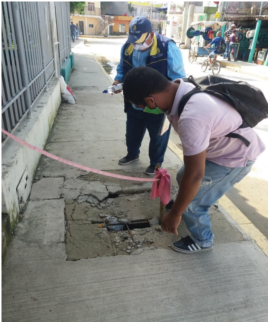
En trabajo de rutina encontramos este riesgo eminente en el Pozon .
