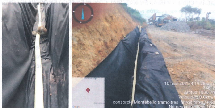
Ilustración 28. Tubería de drenaje en el tramo 2
