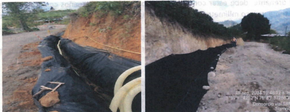
Ilustración 49. Tubería de drenaje en el tramo 3.
