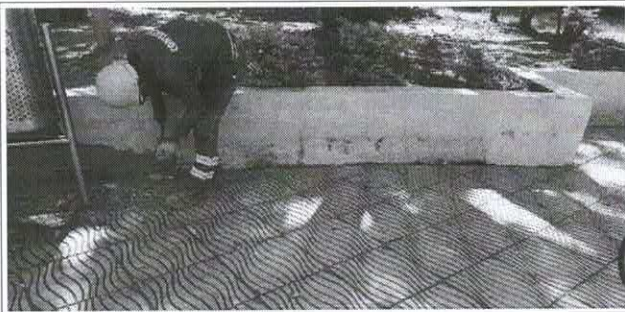
Estado inicial típico de muros a reconstruir pañetes y vigas
