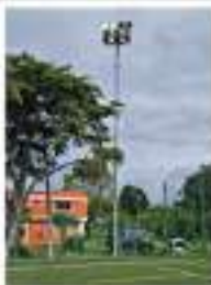
Torre 2 Iluminacion Nor occidental 20250307.jpeg 373K
