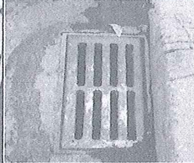
Limpieza de sumideros
