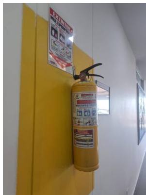
Imagen 11. Extintores sede INCAP.
