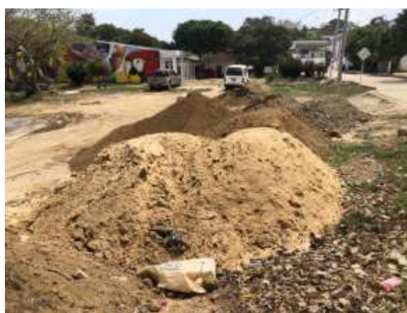
Imagen 8. Acopio de materiales pétreos de forma inadecuada.
