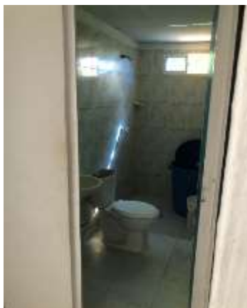
Imagen 25. Unidad sanitaria de oficinas.
