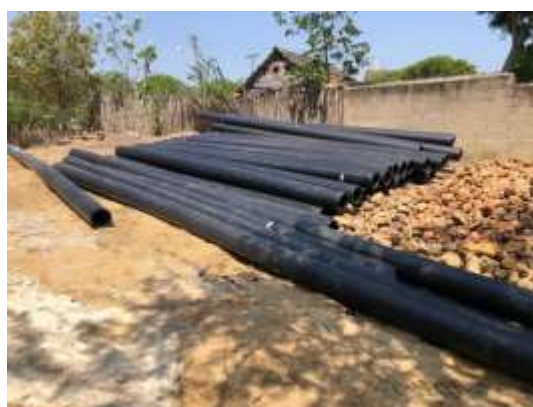
Ilustración 9. Acopio de materiales de forma inadecuada
