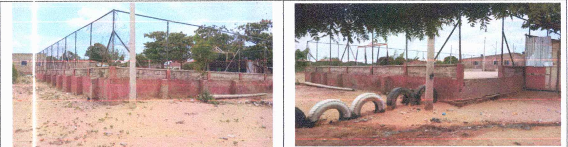
Vista estado actual del exterior cancha deportiva los Cerezos – Cerramiento y accesos (en mal estado)
