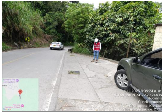
Imagen No. 1: Verificación de instalación de los GPS 3 y 4
