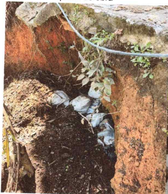
Socavación por pérdida de tubería
