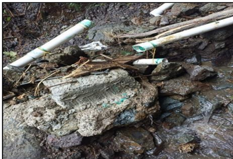
Foto 2 Estado actual de las redes acueducto Guayabal de Pena.
