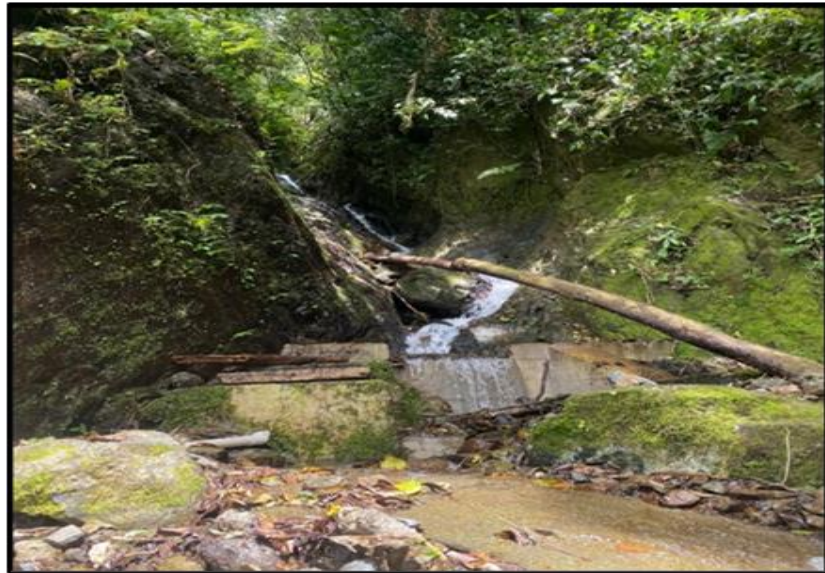
Foto 3 Estado actual de la Bocatoma Guayabal de Pena.
