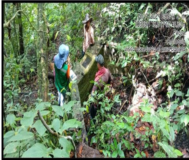
Foto 1. Estado actual de la Bocatoma de la vereda el Aura.
