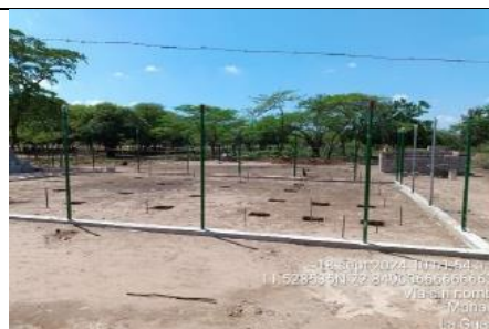
2.Cerramiento para paneles - Comunidad Santa Lucia
