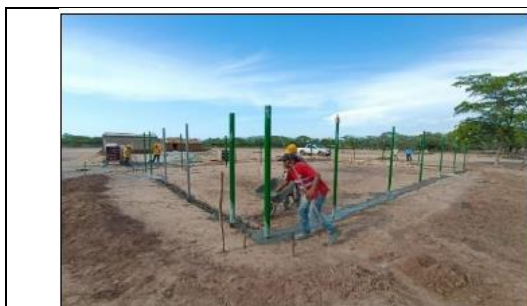
1.Cerramiento para paneles - Comunidad Santa Lucia
