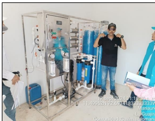
Ilustración 14. Equipo de osmosis inversa
