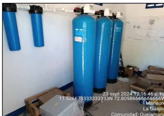
Ilustración 24. Lechos filtrantes - Comunidad Quejamana Fuente: Elaboración propia.
