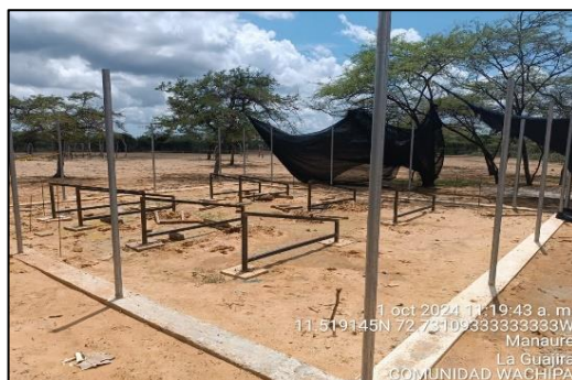
Ilustración 37. Estructura para paneles - Comunidad Wachipa.
