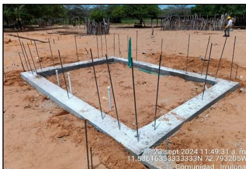
Ilustración 33. Caseta planta de tratamiento - Comunidad Irrujunai
