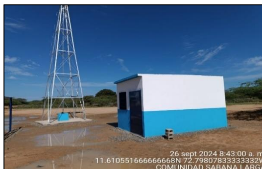
Ilustración 25. Caseta planta de tratamiento - Comunidad Sabana larga Fuente: Elaboración propia.
