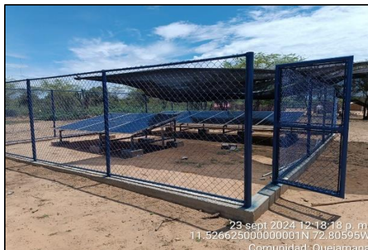
Ilustración 23. Paneles solares - Comunidad Quejamana Fuente: Elaboración propia.
