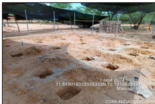
Ilustración 36. Estructura para paneles - Comunidad Wachipa.
