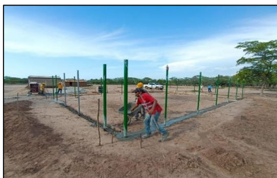
Ilustración 28. Cerramiento para paneles - Comunidad Santa Lucia Fuente: Elaboración propia.
