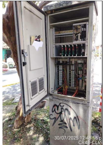
Controlador operativo con acometida nueva
