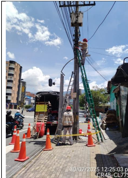
Conexión acometida a transformador
