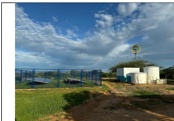
Fotografía 1. Sistema de tratamiento en la comunidad de Maniature.
