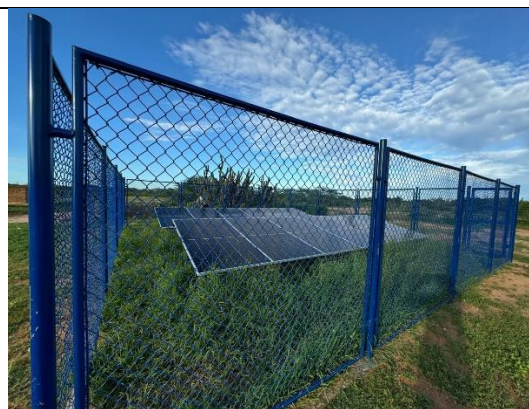
Fotografía 4. Presencia de maleza en zona de paneles solares.
