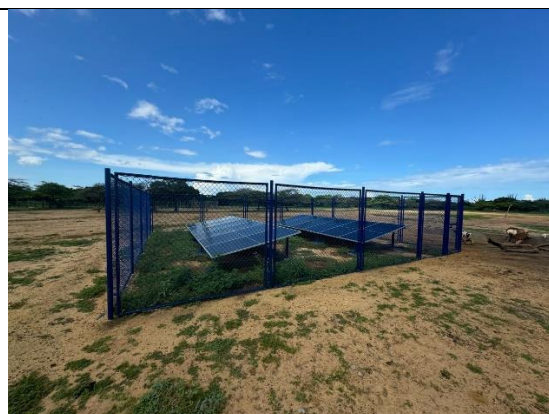
Fotografía 2. Cerramiento en zona de paneles solares.
