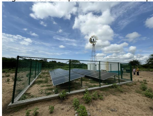
Fotografía 3. Presencia de maleza en área de paneles solares. Se recomendó a la comunidad realizar limpieza periódica.
