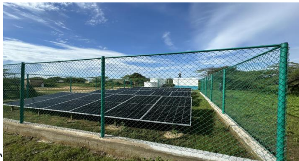
Fotografía 1. Presencia de maleza en área de paneles solares. Se recomendó a la comunidad realizar limpieza periódica.
