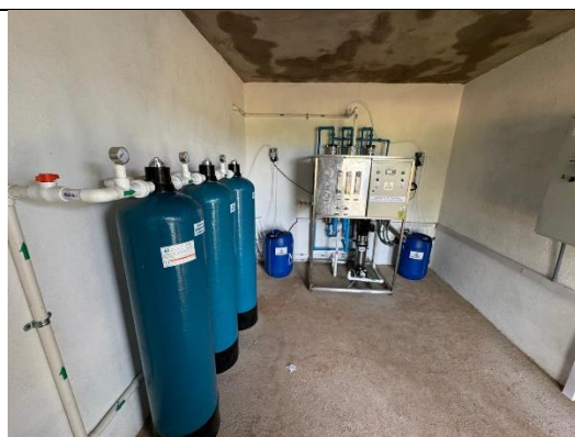
Fotografía 2. Sistema de tratamiento.
