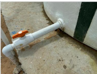
Fotografía 2. Presencia de Fuga en tubería que conecta con tanque de agua potable.
