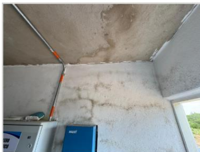
Fotografía 1. Presencia de humedad en placa superior y muros de caseta, lo cuales están llegando a la parte donde se encuentra el
