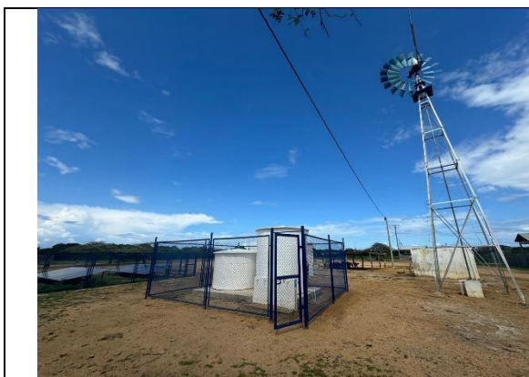
Fotografía 1. Sistema de tratamiento en la comunidad de Cojemana.
