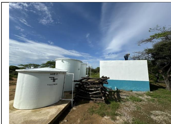
Fotografía 1. Sistema de tratamiento en la comunidad de Maicaito.
