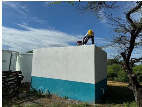
Fotografía 3. Al momento de la visita el contratista hizo presencia con personal para realizar impermeabilización de la cubierta, pero estos solo lo hicieron en una de las esquinas de la placa, por lo que se le sugirió realizarlo completamente, ya que así la filtración penetraría por el resto de la placa.
