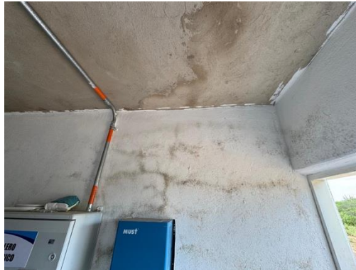
Fotografía 1. Presencia de humedad en placa superior y muros de caseta, lo cuales están llegando a la parte donde se encuentra el gabinete eléctrico, esto requiere intervención urgente.
