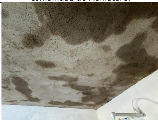
Fotografía 3. Filtración por placa superior.
