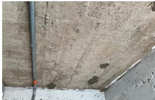
Fotografía 2. Presencia de humedad en placa superior y muros de caseta. Esta placa cuenta con un acabado deficiente, teniendo en cuenta que son a la vista.
