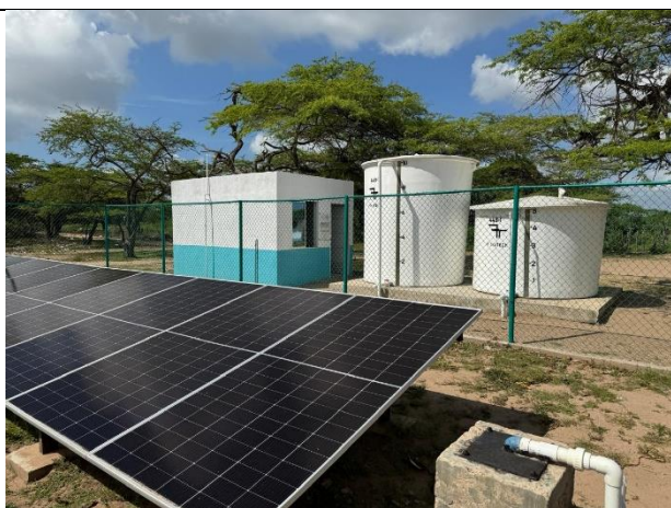
Fotografía 7. Sistema de tratamiento en la comunidad de Maku.
