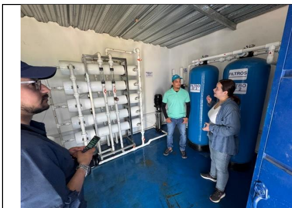
Fotografía 1. Explicación de la intervención realizada en la comunidad de Petsuapa, planta de Osmosis inversa.
