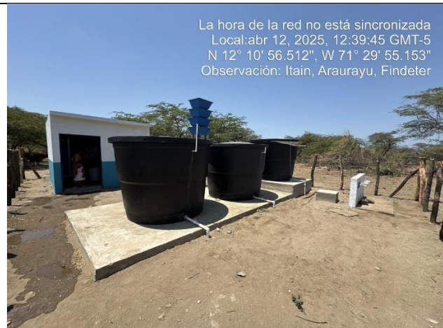
Fotografía 4. Sistema de tratamiento de la comunidad.
