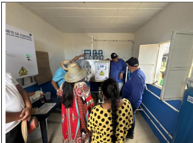
Fotografía 1. Capacitación técnica del sistema de osmosis inversa.
