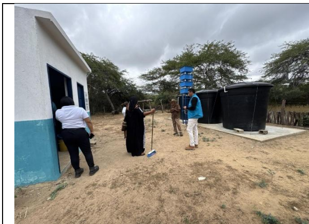
Fotografía 1. Capacitación técnica del sistema de osmosis inversa.
