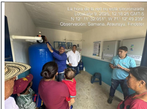
Fotografía 1. Capacitación técnica del sistema de osmosis inversa.
