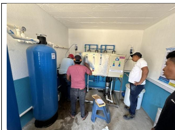
Fotografía 1. Capacitación técnica del sistema de osmosis inversa.
