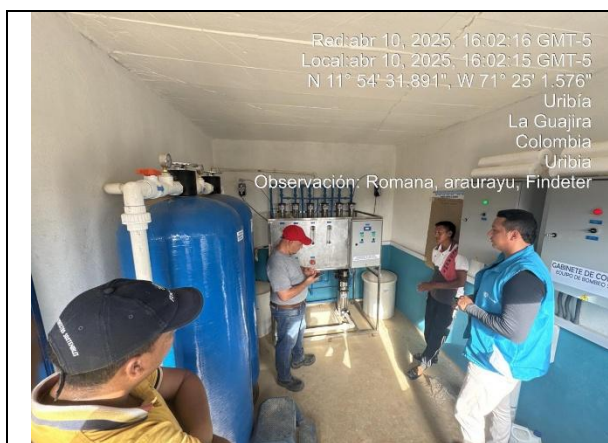
Fotografía 1. Capacitación técnica del sistema de osmosis inversa.
