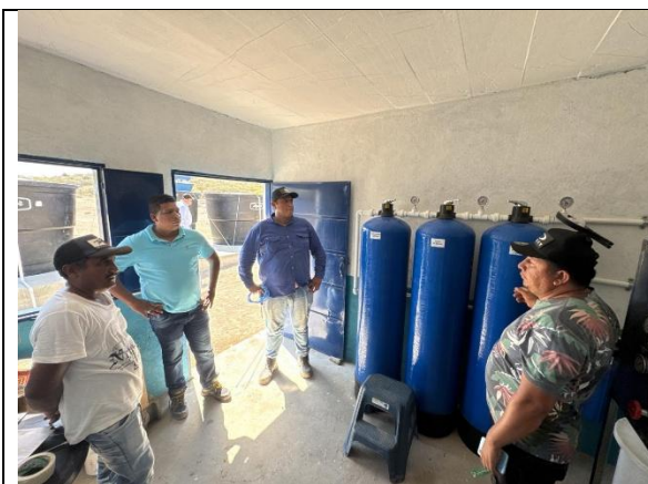
Fotografía 1. Capacitación técnica del sistema de osmosis inversa.
