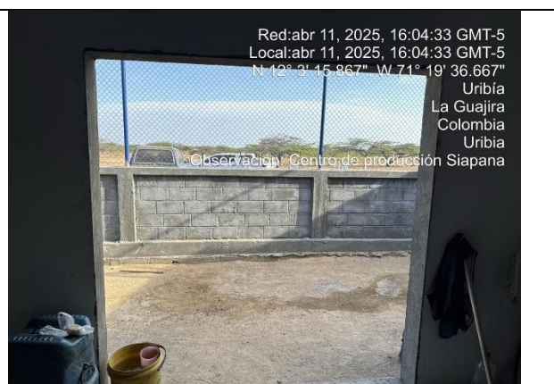
Fotografía 2. Hace falta puerta de acceso a sistema.
