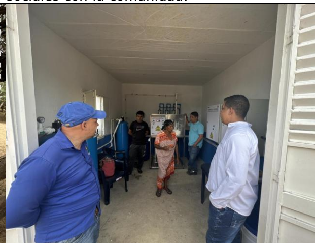
Fotografía 4. Refuerzo técnico para la operación del sistema.
