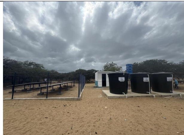
Fotografía 4. Sistema de tratamiento de la comunidad.
