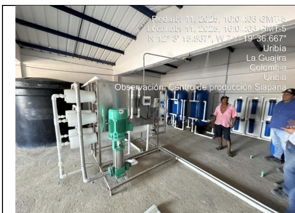
Fotografía 1. Sistema de osmosis inversa. No funciona
