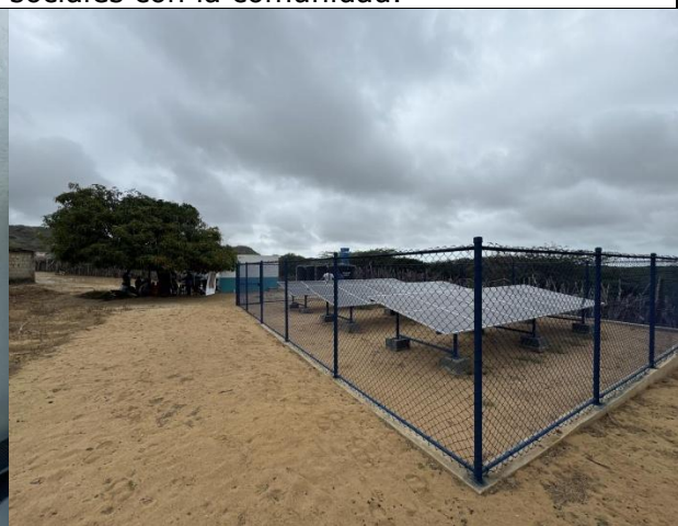
Fotografía 4. Sistema de tratamiento de la comunidad.
