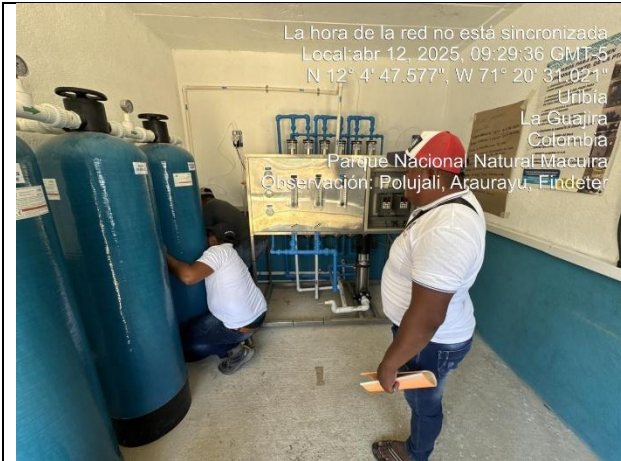
Fotografía 1. Capacitación técnica del sistema de osmosis inversa.
