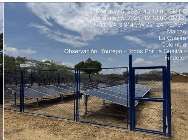
Fotografía 8. Paneles solares instalados en la comunidad de Yourepo.
