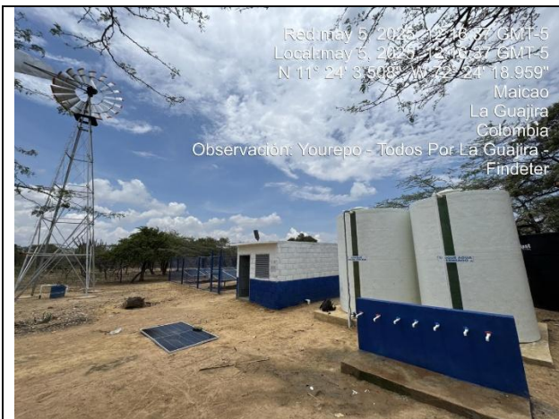
Fotografía 7. Sistema de tratamiento de agua potable en la comunidad de Yourepo.
