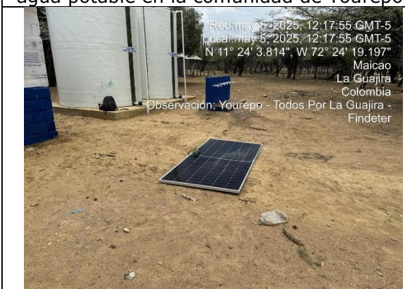
Fotografía 9. Panel solar que fue reemplazado en la comunidad de Yourepo.
