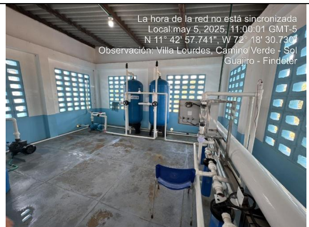
Fotografía 2. Sistema en funcionamiento con la bomba de baja propiedad de la comunidad de Villa Lourdes Camino Verde.
