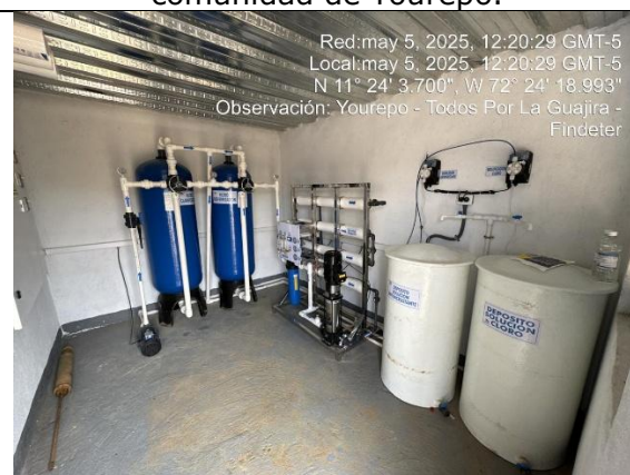
Fotografía 10. Sistema de tratamiento por osmosis inversa en la comunidad de Yourepo.
