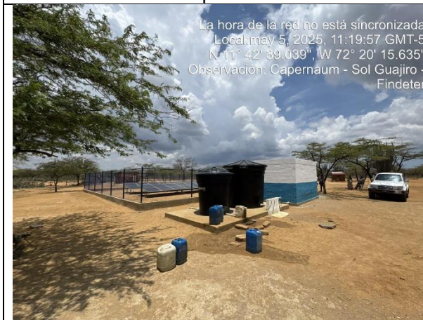
Fotografía 5. Sistema de tratamiento de agua potable en la comunidad de Capernaum.
