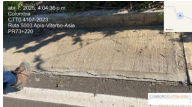
Figura 6 Cuneta desplazada PR73+220
