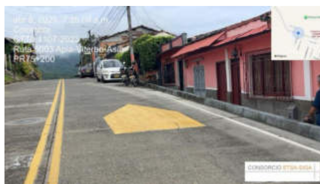
Figura 10 Pintura de cruce escolar inconclusa PR75+200
