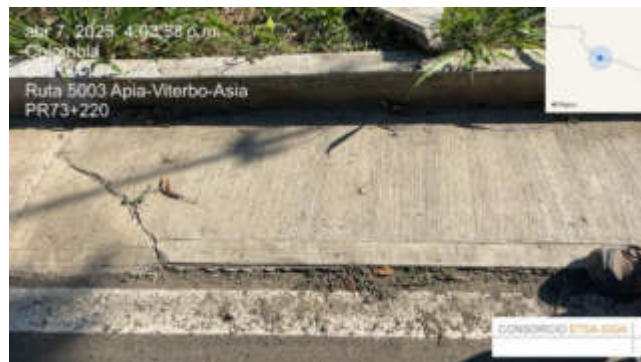
Figura 5 Cuneta fracturada PR73+220
