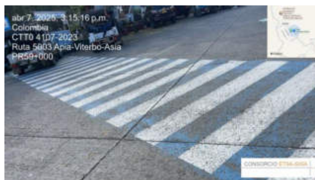
Figura 2 Estado actual de la pintura instalada en el parque Apía PR59+000
