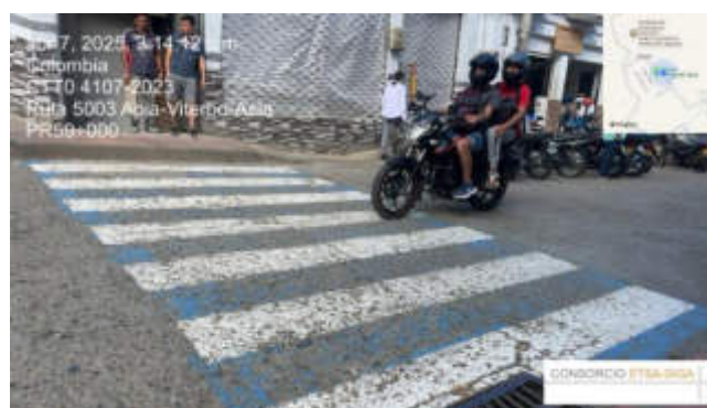
Figura 1 Estado actual de la pintura instalada en el parque Apía PR59+000
