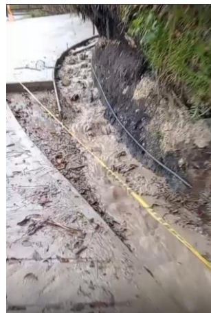
Ilustración 20. Escorrentía de superficial en obra, lluvias constantes.
