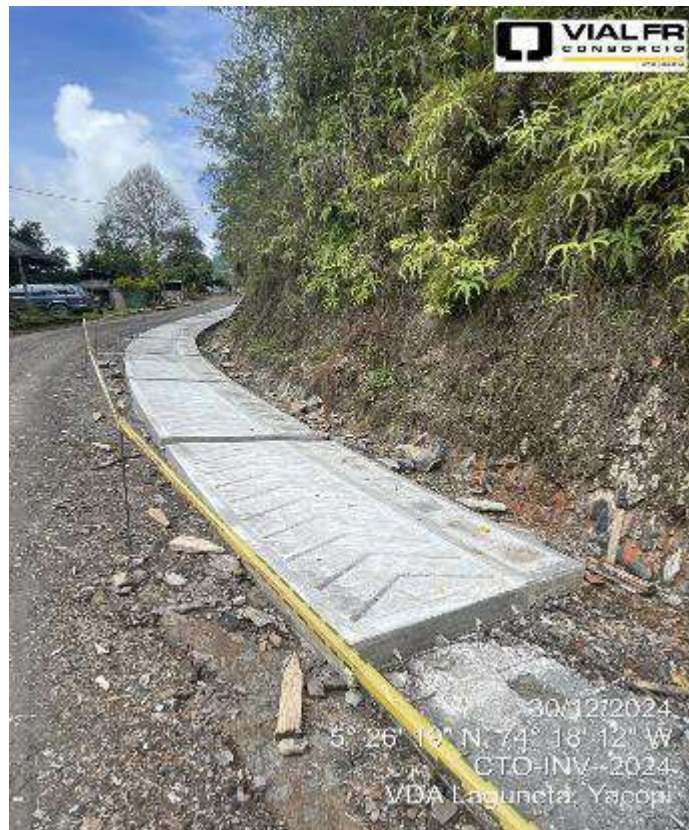
SEÑALIZACION DE PLACA HUELLA
