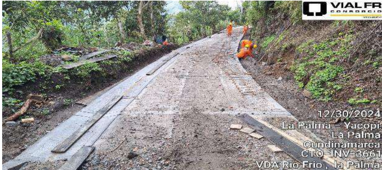
CUNETA TIPO V
