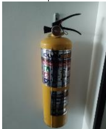
Fotografía No. 50 Extintor del pasillo
