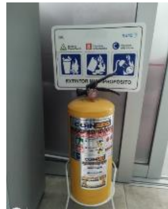
Fotografía No. 49 Extintor de la cocina
