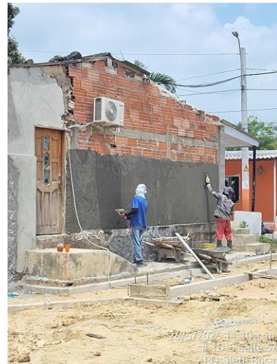
Pañete sobre muro vecino
