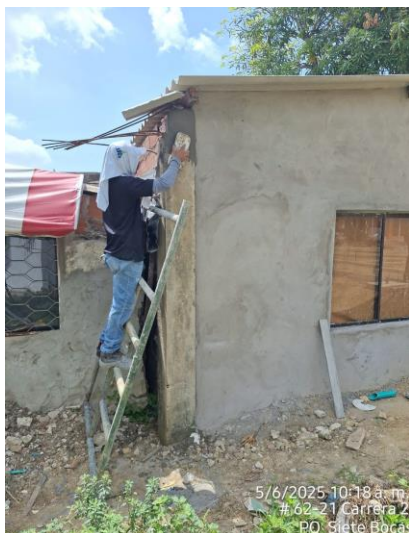
Pañete sobre muro vecino
