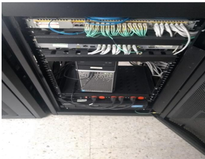
Rack de Datos Patch Panel Fibra
