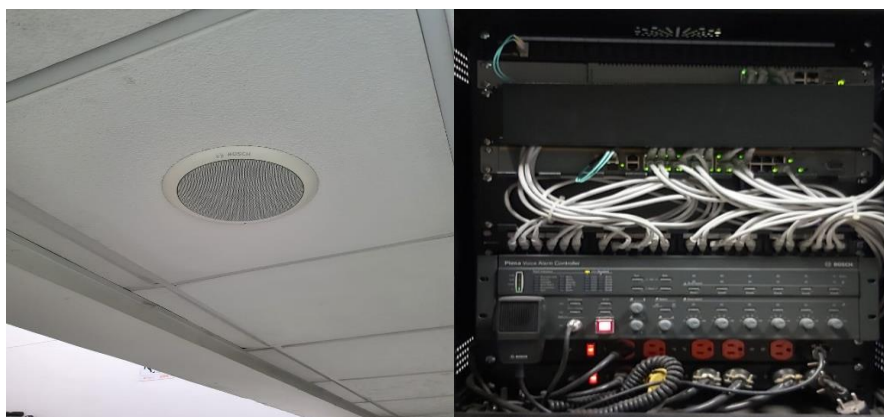
Parlante Bosch Equipos Cuarto Comunicaciones
