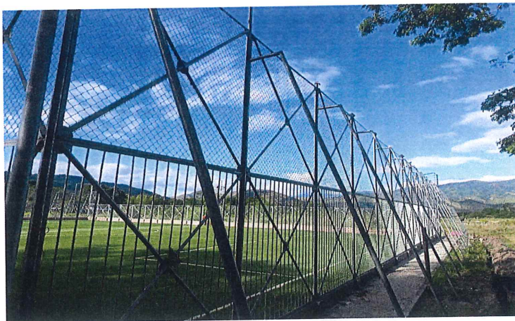
Pie De amigo en tubería galvanizada
