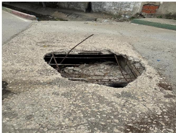
Ilustración 2 Registro fotografico del absceso que presenta la losa superior del box culvert.
