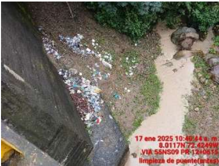
LIMPIEZA DE PONTON (ANTES)
