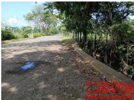
LIMPIEZA DE PONTON (ANTES)
