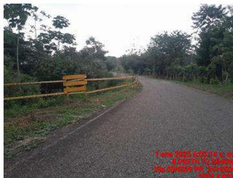
SEGUIMIENTO SEÑALIZACION SITIOS CRITICOS
