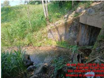
LIMPIEZA DE PONTON (ANTES)
