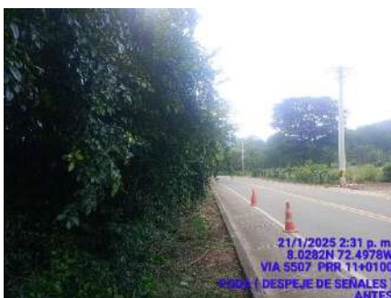
DESPEJE DE SEÑALES (ANTES)
