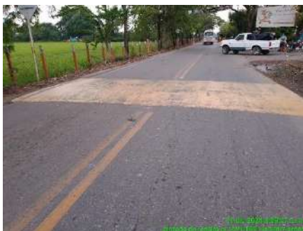
PINTURA DE RESALTOS (ANTES)
