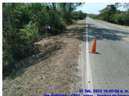
LIMPIEZA DE ENCOLE (ANTES)
