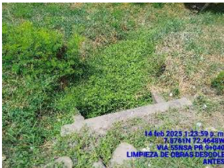
LIMPIEZA DE DESCOLE (ANTES)
