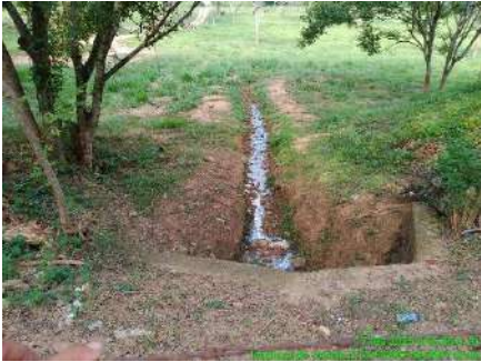
LIMPIEZA DE ENCOLE (ANTES)
