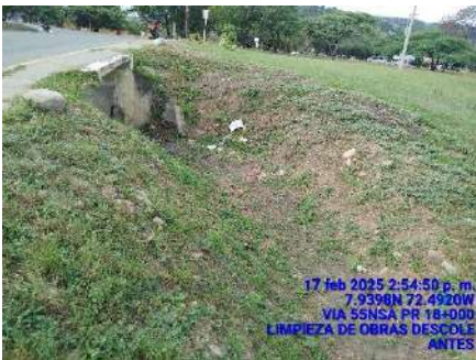
LIMPIEZA DE DESCOLE (ANTES)
