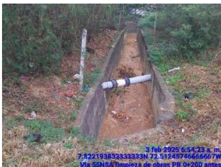
LIMPIEZA DE DESCOLE (ANTES)
