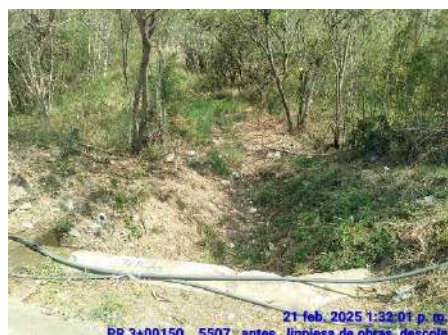
LIMPIEZA DE DESCOLE (ANTES)
