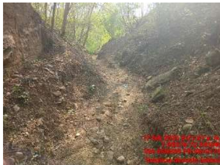
LIMPIEZA DE DESCOLE (ANTES)
