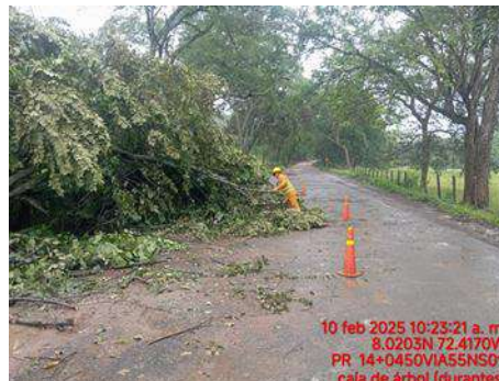
SEGUIMIENTO SEÑALIZACION VIAL ADECUADA EN EMERGENCIA
