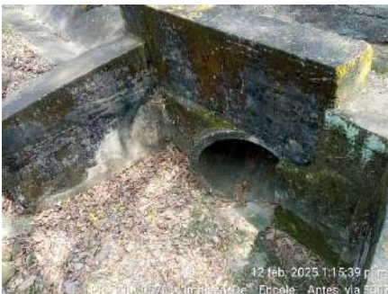
LIMPIEZA DE ENCOLE (ANTES)
