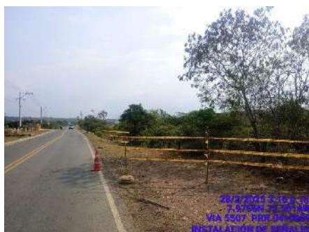
LIMPIEZA DE ENCOLE (ANTES)
