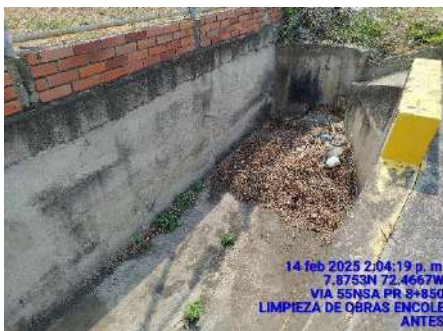
LIMPIEZA DE ENCOLE (ANTES)
