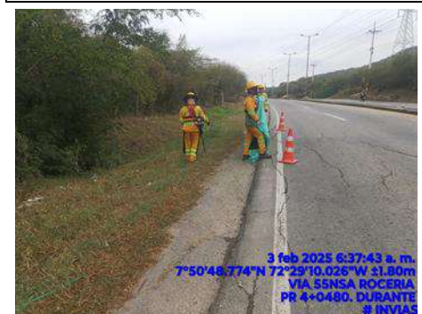
SEGUIMIENTO USO DE BARRERA DE SEGURIDAD
