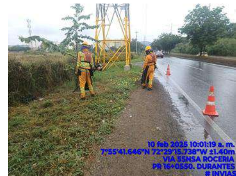
SEGUIMIENTO USO DE BARRERA DE SEGURIDAD
