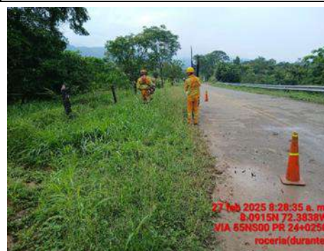
SEGUIMIENTO USO DE BARRERA DE SEGURIDAD
