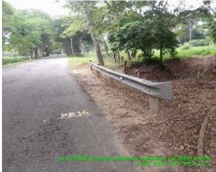
LIMPIEZA DE DEFENSA METALICA (ANTES)
