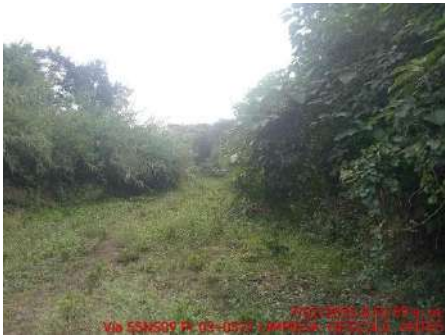
LIMPIEZA DE DESCOLE (ANTES)
