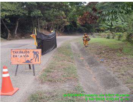
SEGUIMIENTO USO DE BARRERA DE SEGURIDAD
