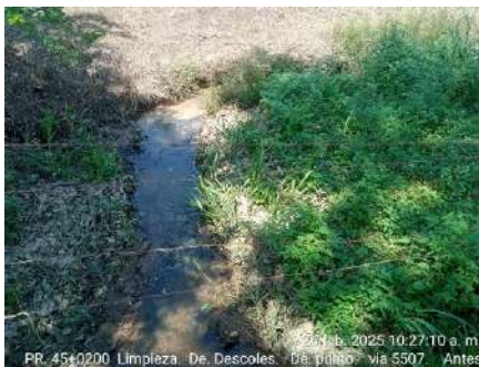
LIMPIEZA DE DESCOLE (ANTES)
