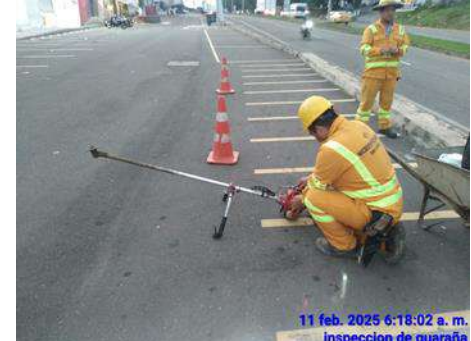
SEGUIMIENTO INSPECCION DE HERRAMIENTAS MECANICAS
