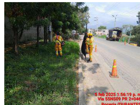
SEGUIMIENTO USO DE BARRERA DE SEGURIDAD
