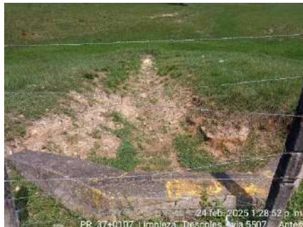
LIMPIEZA DE ENCOLE (ANTES)
