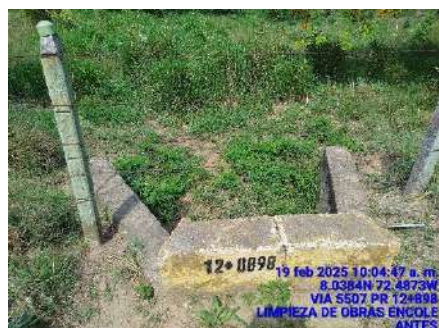
LIMPIEZA DE ENCOLE (ANTES)
