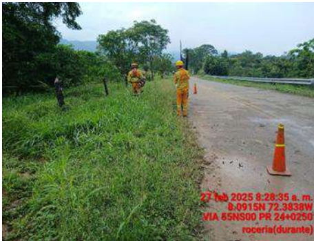
SEGUIMIENTO USO DE BARRERA DE SEGURIDAD
