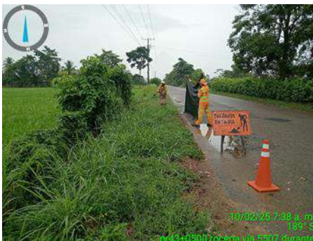
SEGUIMIENTO USO DE BARRERA DE SEGURIDAD
