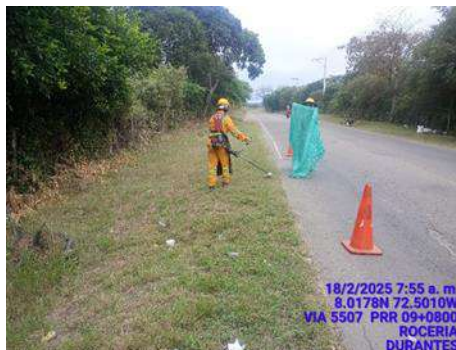
SEGUIMIENTO USO DE BARRERA DE SEGURIDAD
