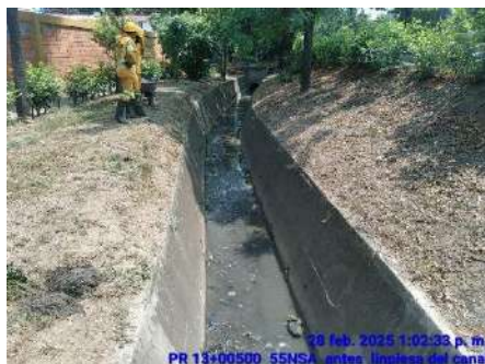
LIMPIEZA DE DESCOLE (ANTES)
