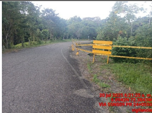
SEÑALIZACION SITIO CRITICO (DESPUES)
