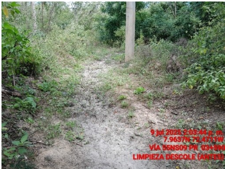
LIMPIEZA DE ENCOLE Y DESCOLE (ANTES)
