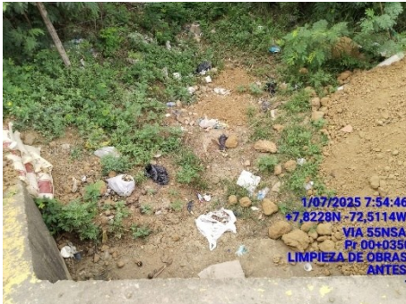
LIMPIEZA DE ENCOLE Y DESCOLE (ANTES)
