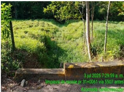
LIMPIEZA DE ENCOLE Y DESCOLE (ANTES)
