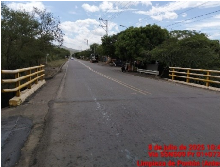
LIMPIEZA DE PONTON (ANTES)
