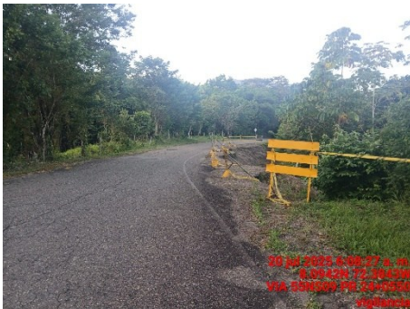
SEÑALIZACION SITIO CRITICO (ANTES)
