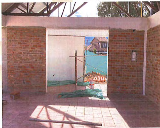
Instalación medidora eléctrico y tomacorriente
