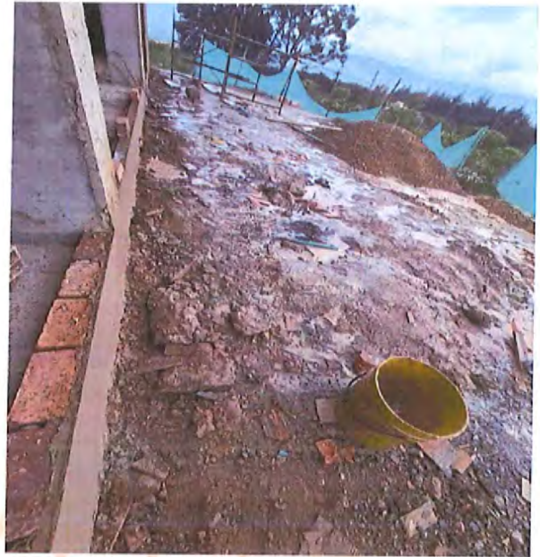
Fraguado de material agregado en superficie
