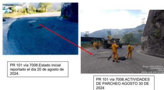
Imagen 8.2. Estado antes y después del PR 101+000 via 7008
