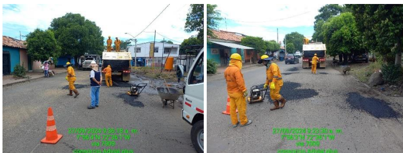
Imagen 8.58 y 8.59 Parcheo PR 55+600 al PR 57+600 vía 7009
