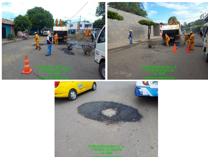
Imagen 5.16 y 5.17. Parcheo PR 55+600 al PR 57+600 vía 7009
