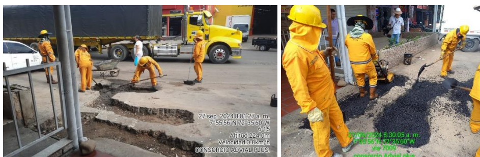
Imagen 5.14 y 5.15. Parcheo PR 55+600 al PR 57+600 vía 7009
