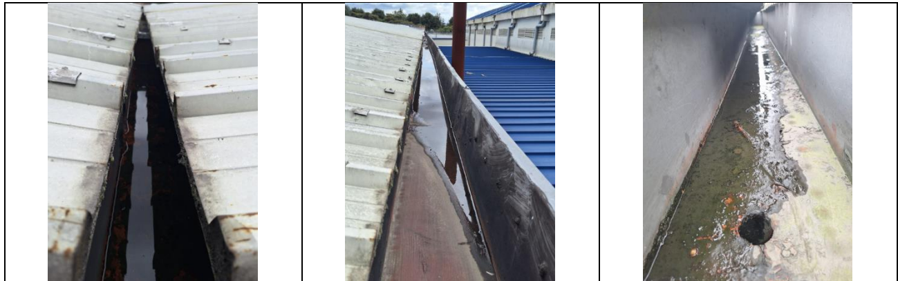
Fotografías 4 – 6. Bodegas Álamos – Ejemplo de elementos que requieren intervención.
