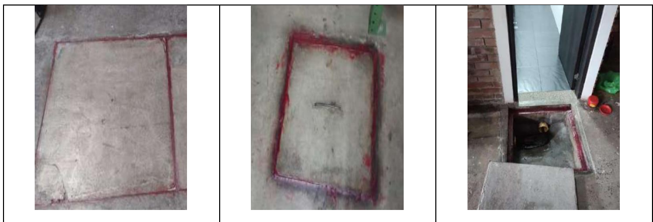
Fotografías 7 – 9. Bodegas Álamos – Ejemplo de elementos que requieren intervención – cajas de inspección.
