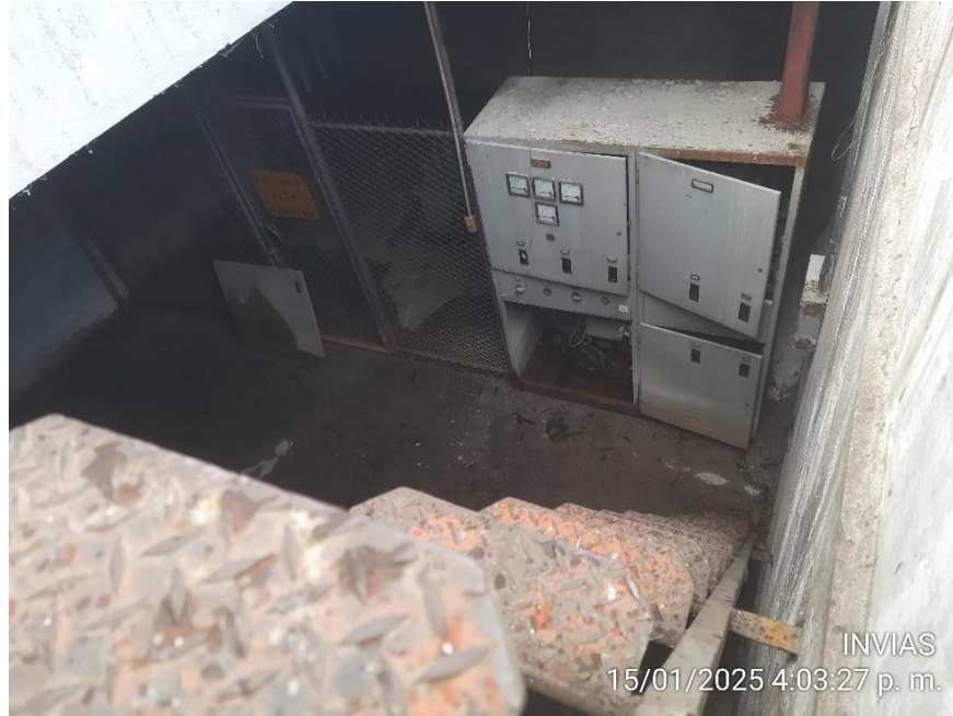
Imagen Estado del cuarto eléctrico de la Sede INVÍAS – Popayán.
