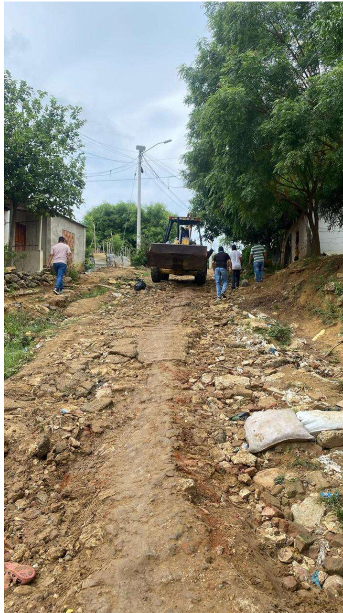
Ilustración 3 estado inicial de via tramo 1
