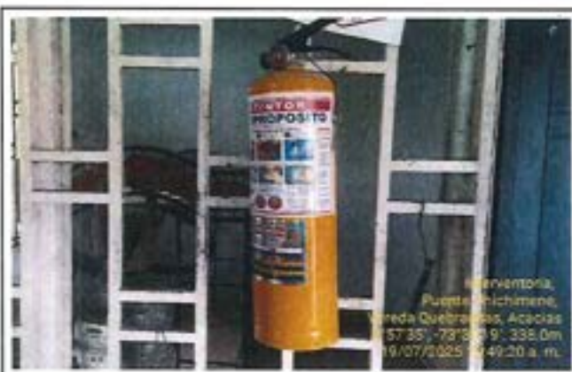
Fotografía 17: Verificación de elementos de emergencia.
