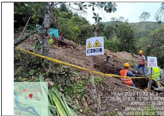
Ilustración 9. Señalización de Seguridad
