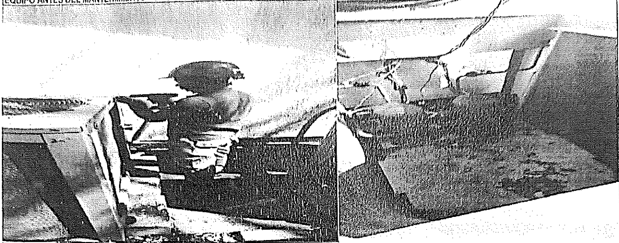
ACTIVIDADES DEL MANTENIMIENTO
