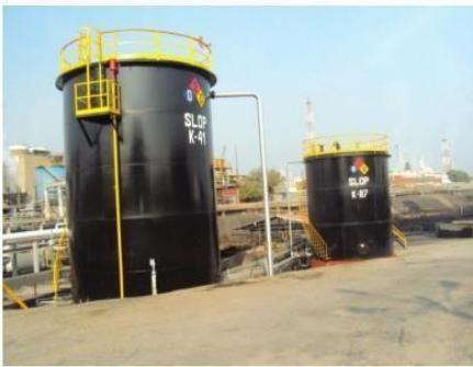
Foto 2. Tanques Cilíndricos Verticales
