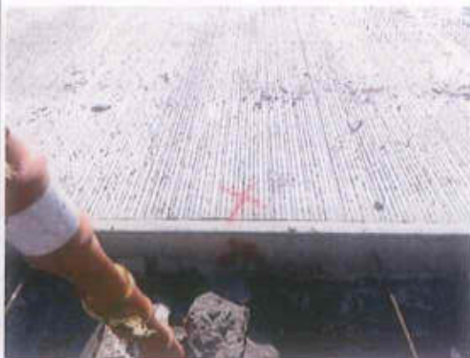
Abs K2+292: Fisura a 0,8m del corte
