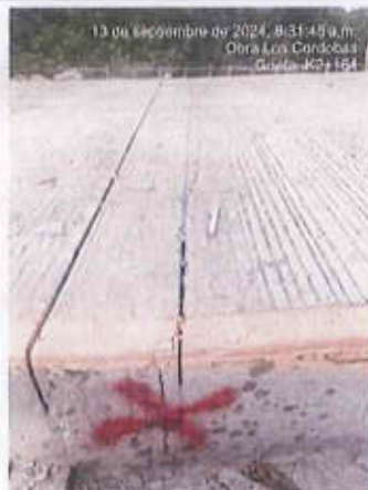
Abs K2+161,72: Fisura a 0,2 m del corte
