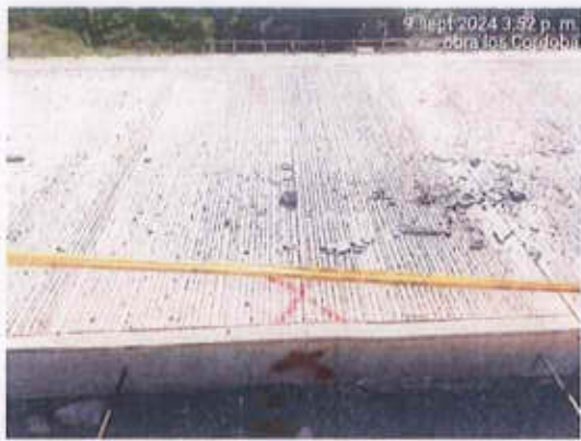
Abs K2+282,7: Fisura a 0,8m del corte
