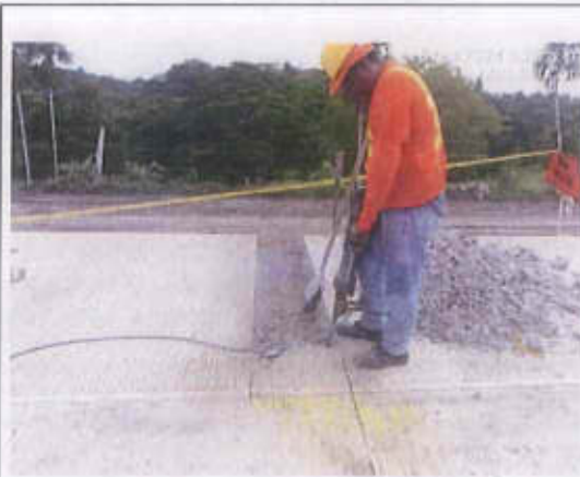
Abs K2+098,08: Fisura a 0.5 m del corte
