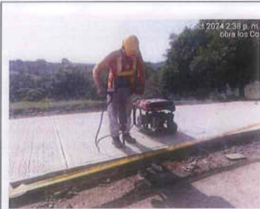
Abs K1+862.38: Fisura en el centro de la losa corte. Se realiza corte de losa completa, demolición
