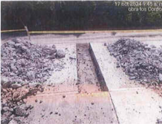
Abs K1+947.88: Fisura a 0.4 m del corte
