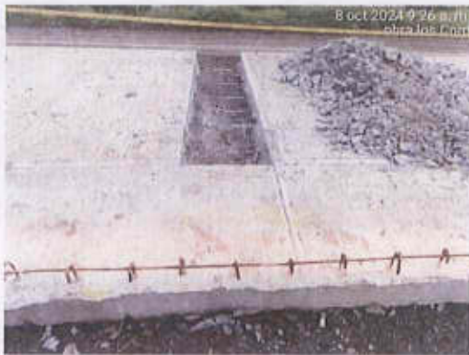
Abs K2+108,28: Fisura a 0.4 m del corte
