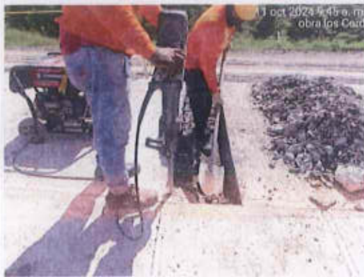
Abs K2+026.68: Fisura a 0.3 m del corte
