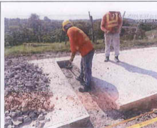
Abs K1+875.58: Fisura a 0.4 m del corte. Se realiza corte a 0.5 m, demolición y reparación.
