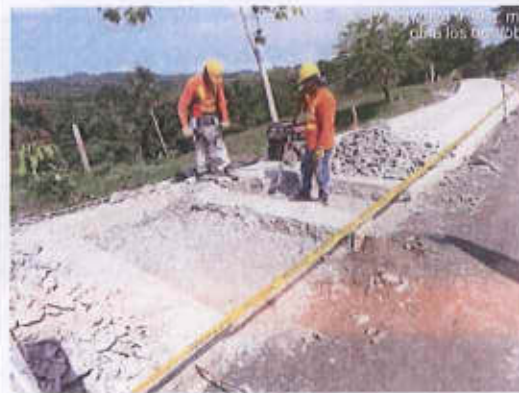
Abs K1+912.58: Fisura en el centro de la losa corte
