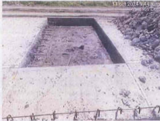
Abs K2+040.88: Fisura a 1.0 m del corte
