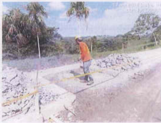
Abs K1+943.05: Fisura en el centro de la losa corte
