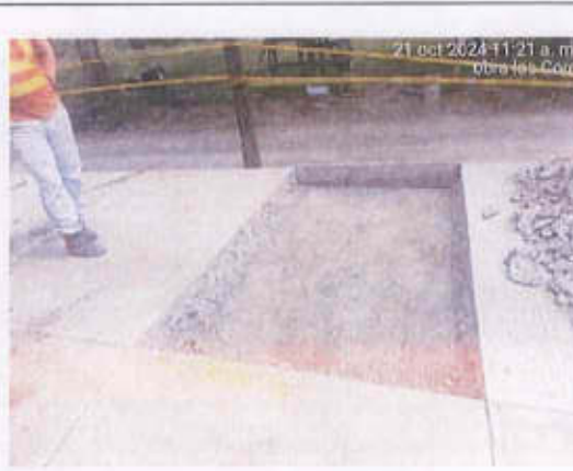
Abs K1+856.48: Fisura a 1.0 m del corte. Se realiza corte a 1.5 m, demolición.
