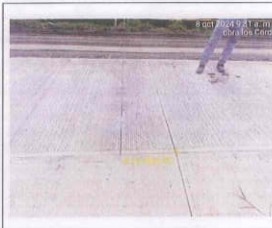
Abs K2+060.58: Fisura a 0.2 m del corte
