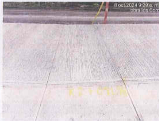
Abs K2+071,98: Fisura a 0.9 m del corte
