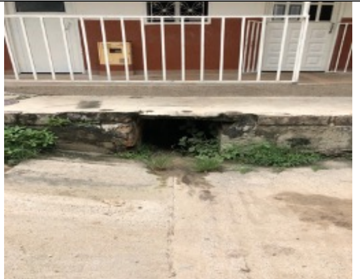
Fotografía 4. Tubería de desagüe en el barrio Fátima, la cual no es suficiente cuando se presentan precipitaciones altas Fuente: Autor
