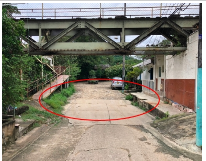
Fotografía 2. Vista del sector principal en donde se presentan estancamientos de agua por la obstrucción del desagüe hacia el río Apulo Fuente: Autor
