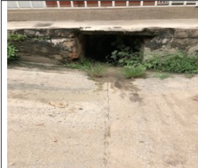
Fotografía 3. Tubería de desagüe ubicada en las vías del barrio Fátima, la cual se obstruye por el estancamiento de agua Fuente: Autor
