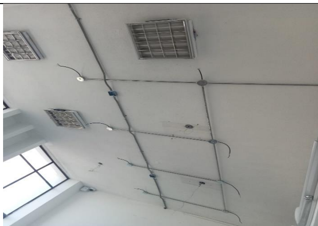
Salidas de puntos de Iluminación
