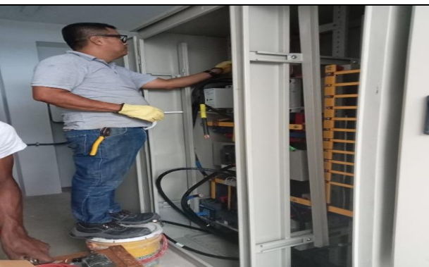
Instalación acometida desde TGA a banco de condensadores
