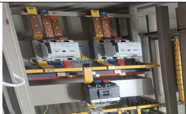
transferencia automática 800A
