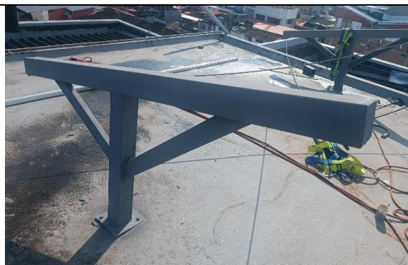
Estructura soporte para paneles
