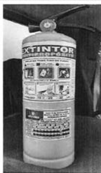
EXTINTOR CON FECHA VIGENTE
