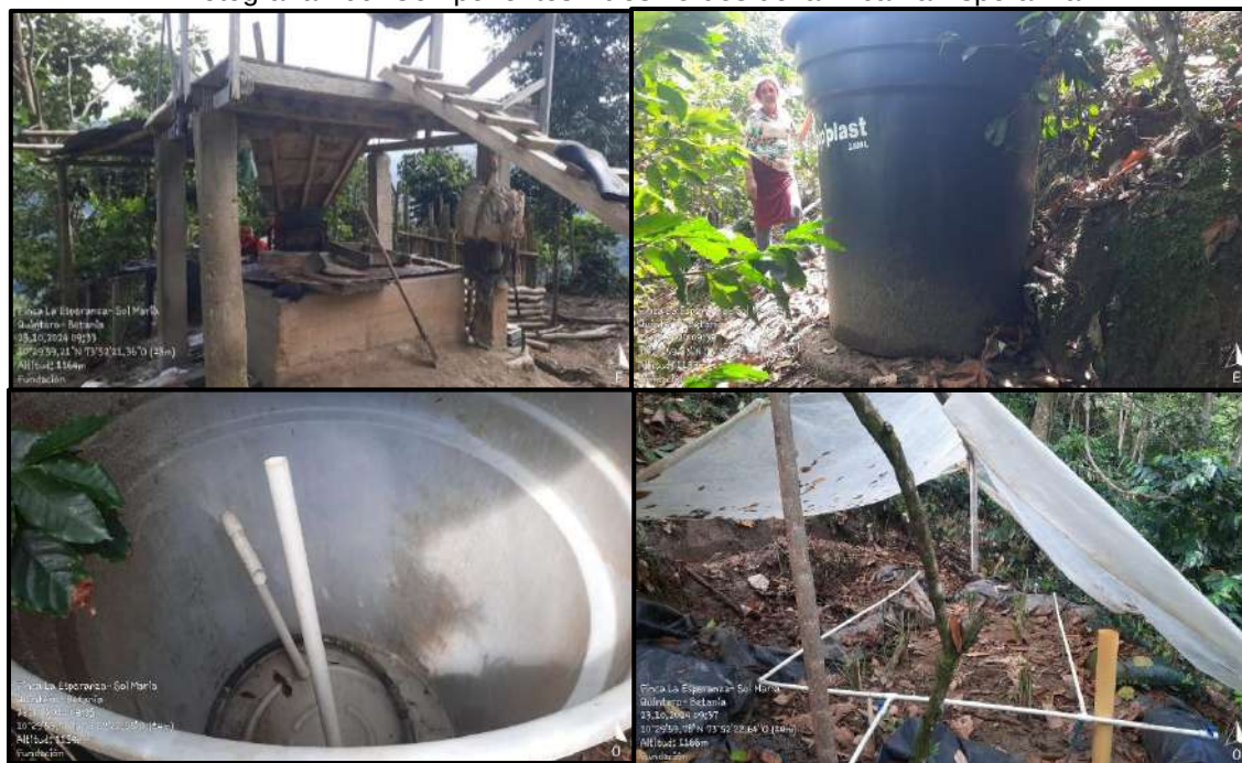
Fotografía 160. Componentes filtros verdes de la finca La Esperanza
