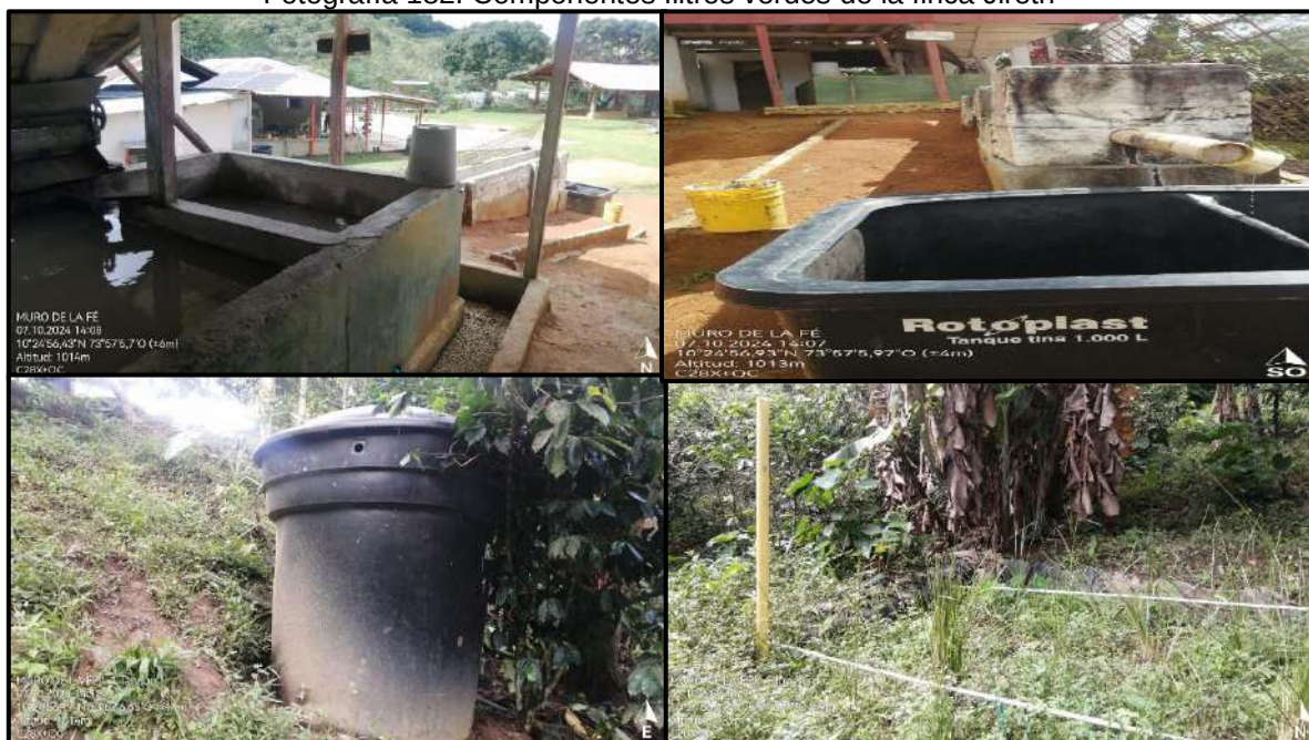
Fotografía 182. Componentes filtros verdes de la finca Jireth
