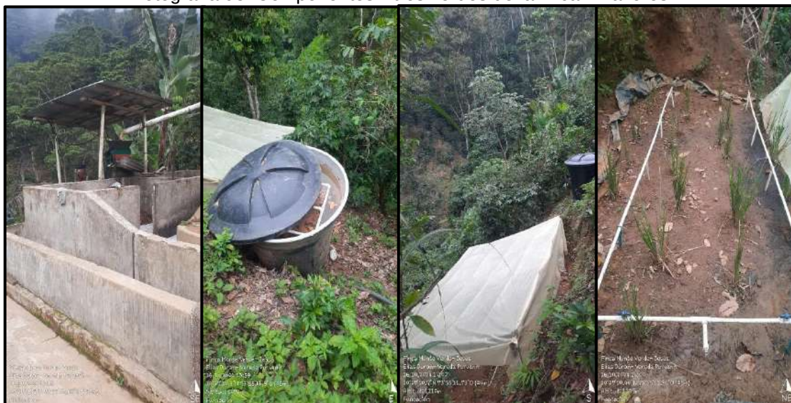
Fotografía 93. Componentes filtros verdes de la finca Miraflores
