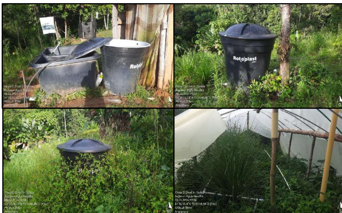
Fotografía 85. Componentes filtros verdes de la finca Sinaí 2
