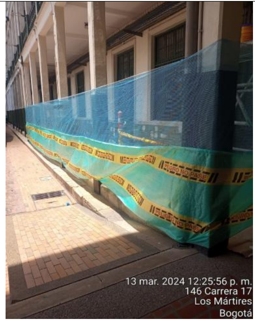
8- SEÑALIZACIÓN EXTERNA HALL
