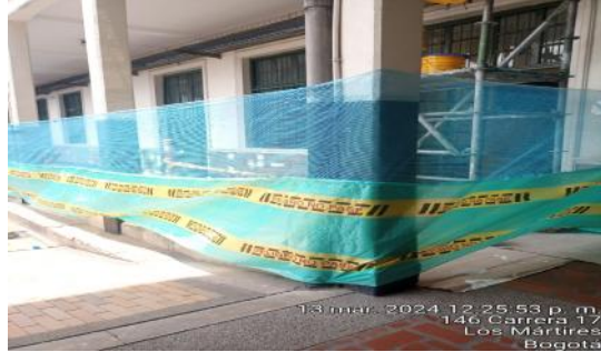
5- SEÑALIZACION EXTERIOR HALL
