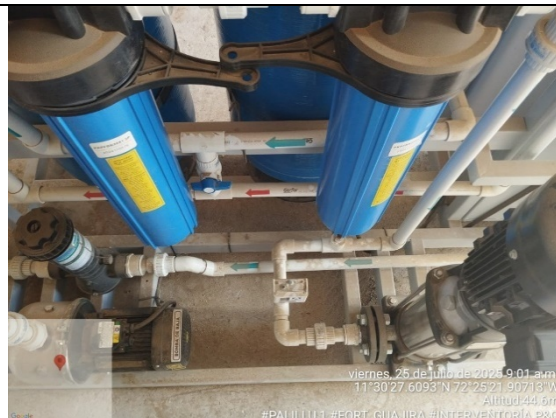
66. Seguimiento de obra. (comunidad PALILLU 1) Vista general de los componentes de la planta de tratamiento.
