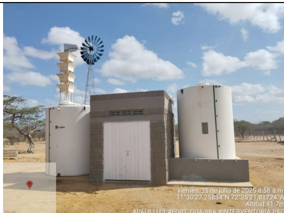
65. Seguimiento de obra. (comunidad PALILLU 1) Vista general de la caseta.
