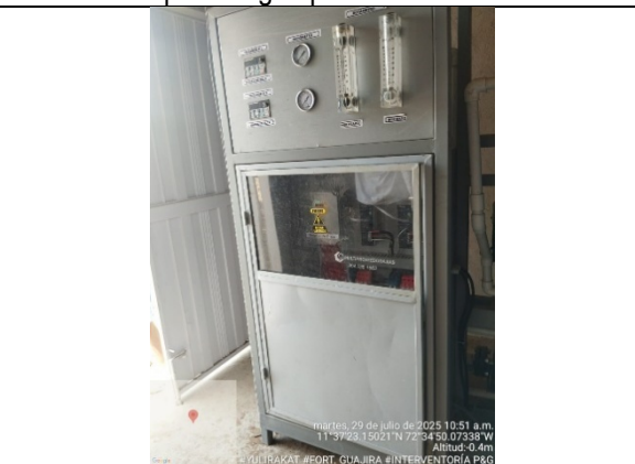
76. Seguimiento de obra. (comunidad YULIRAKAT) Vista general del gabinete eléctrico y panel superior.
