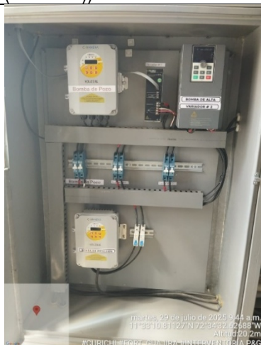
69. Seguimiento de obra. (comunidad CURICHI) Vista general del gabinete eléctrico.
