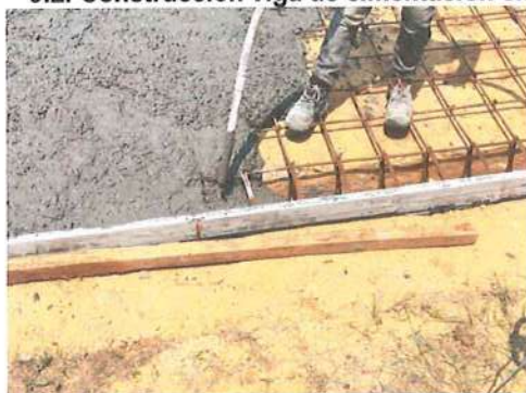
Ilustración No. 67 – Viga de cimentación zona lateral izquierda
