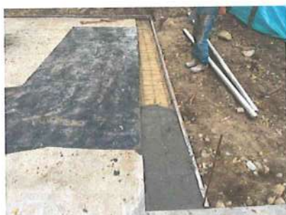
Ilustración No. 49 – Cuneta en concreto zona lateral derecha
