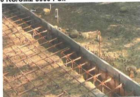
Ilustración No. 42 – viga de cimentación zona lateral derecha
