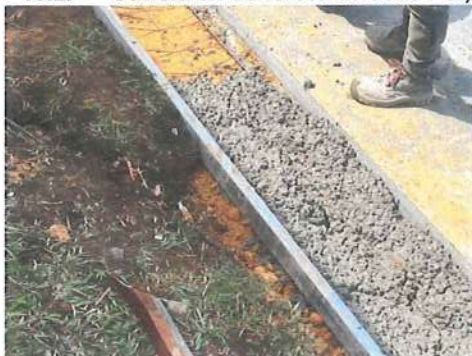
Ilustración No. 58 – Cuneta en concreto zona lateral derecha
