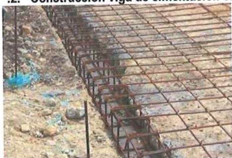
Ilustración No. 41 – Viga de cimentación zona lateral izquierda
