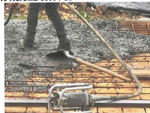
Ilustración No. 68 – viga de cimentación zona lateral derecha
